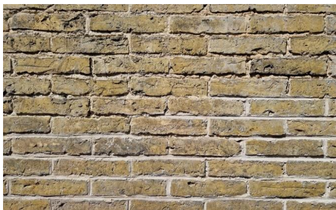
Foto 2 geeft een voorbeeld waarbij voegwerk niet verwijderd is.
