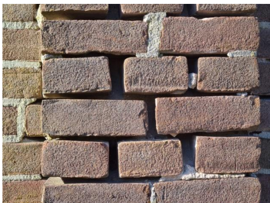
Foto 1. Het hoeft geen nadere toelichting uitgesleten voegwerk dat vervangen dient te worden.
